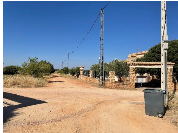
Línea Aérea de distribución eléctrica
