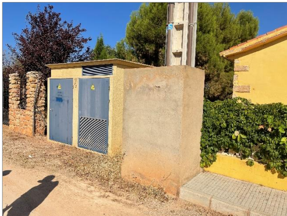
Centro de Transformación
