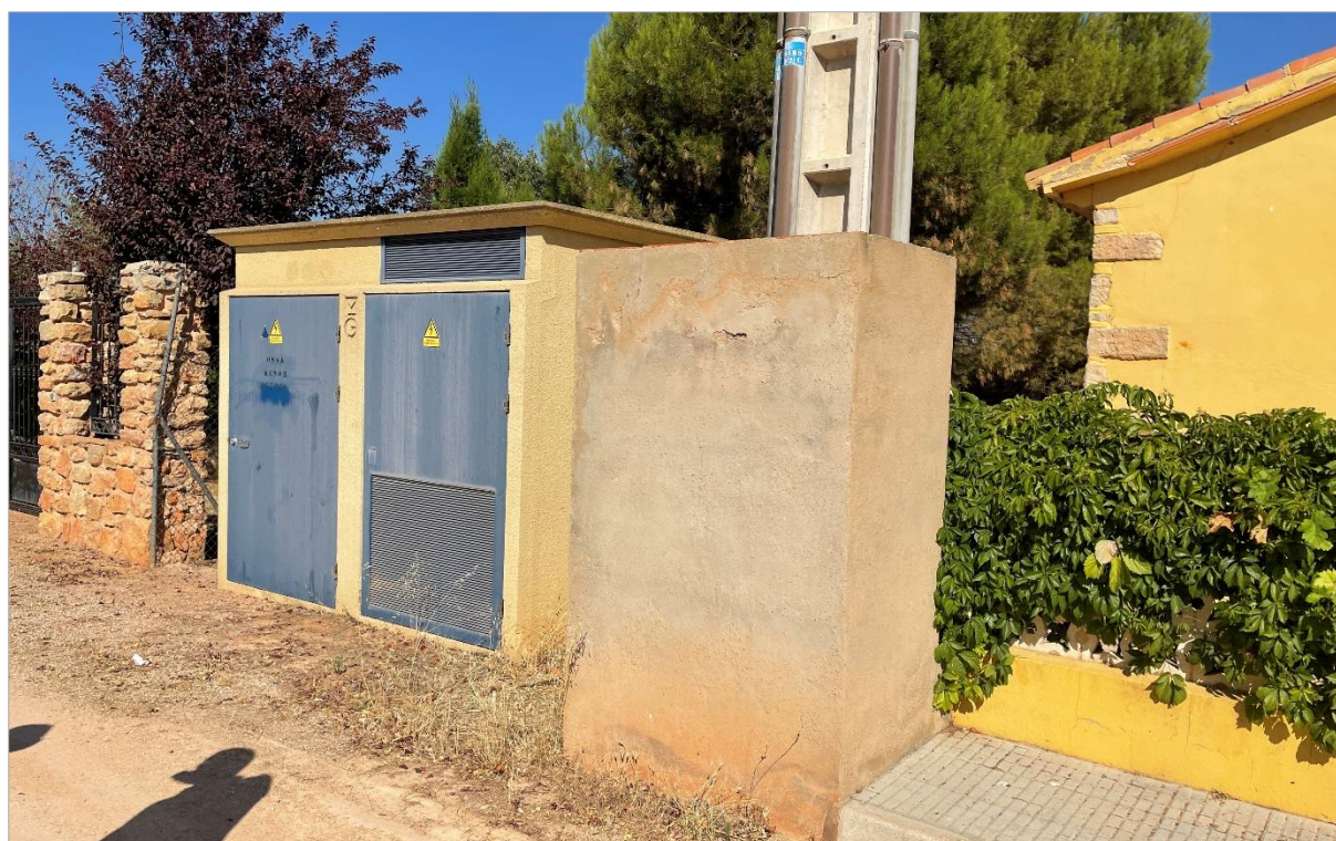
G.10 – Centro de transformación que da servicio a las edificaciones del Sector 14.
